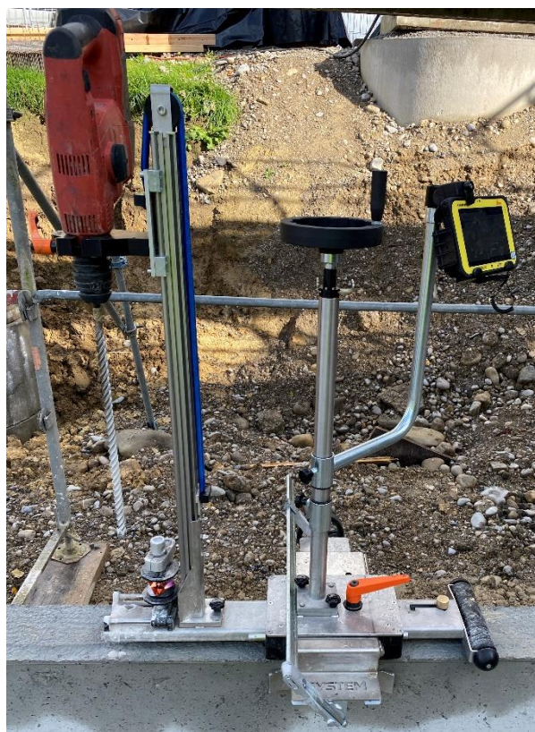
Stexon Gesamtsystem - Bohrhammer, Prisma und Feldrechner
