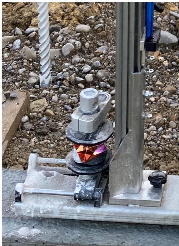
Das zur Seite gefahrene Prisma am Bohrständler gibt den Weg für den Bohrer frei
